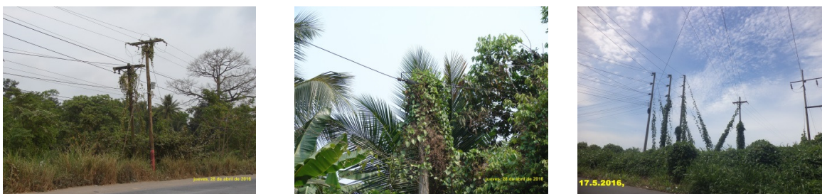
Ilustración 11. Resultados de la Fiscalización (Invasión vegetación) en redes de distribución de Media y Baja Tensión.
