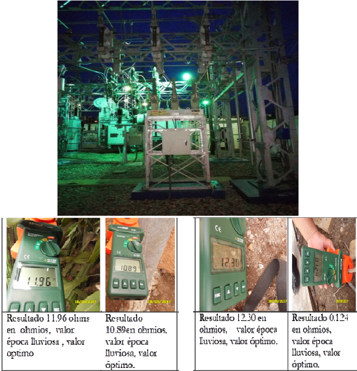
Ilustración 7. Mediciones de algunas puestas a tierra en las EEMs.
