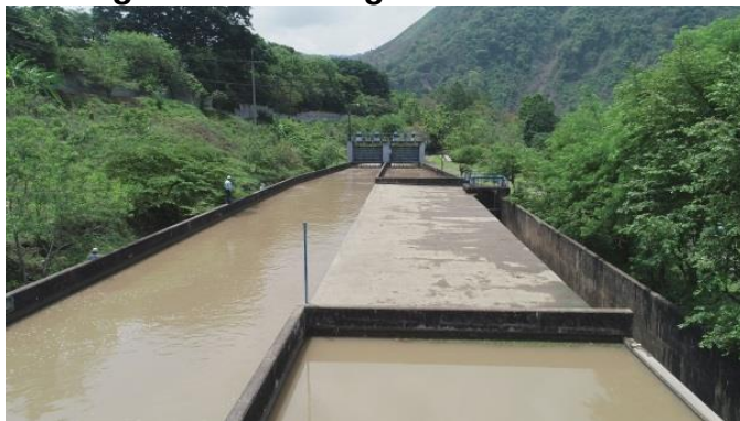
Imagen No. 6 – Segundo desarenador.
