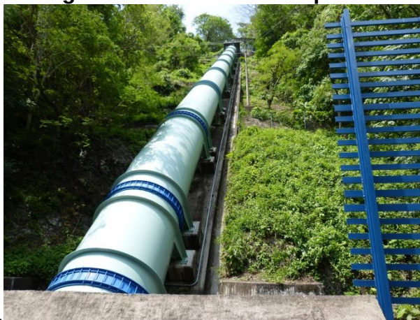
Imagen No. 8 – Tubería de presión.
